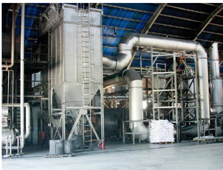
Hình 1: Lò đốt rác y tế tại Công ty TNHH MTV Môi trường đô thị TP.HCM
